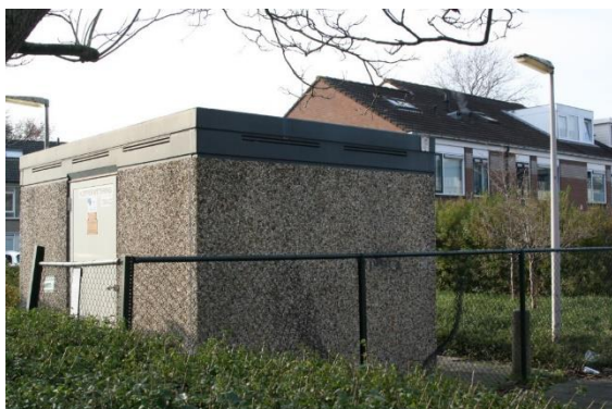
Figuur 11 Voorbeeld van een middenspanningsruimte in Zoeterwoude-Rijndijk (Kopperwetering)
