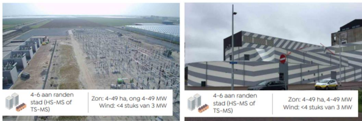
Figuur 6: Voorbeelden van onderstations (bron: Netbeheer Nederland)
