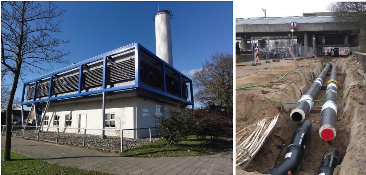
Figuur 9. Links een voorbeeld van een Ketelhuis voor de warmte uitwisseling, rechts een voorbeeld van de aanleg van een warmtenet.
